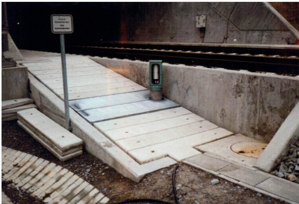
Fig 3 Chute jaugée dans le puits de jonction de câbles du tunnel Freudenstein
