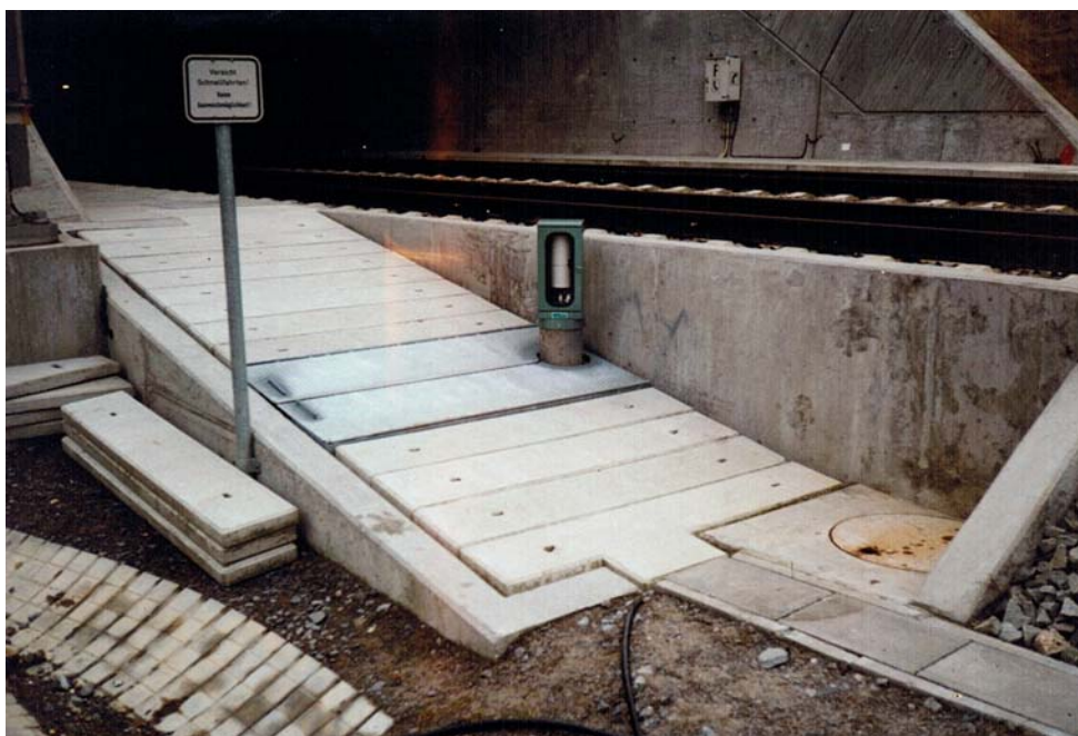
Abb. 3 Messwehr im Kabelenschacht des Freudensteintunnels
